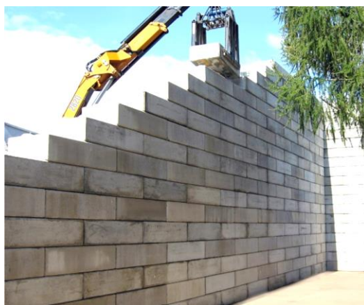
Brandscheiding met (lego)betonblokken
