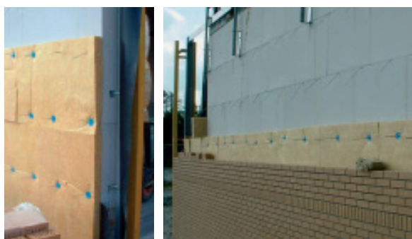
Glaswol wordt aangebracht in de spouwruimte van deze wand. Deze wijze van isoleren is brandveilig. Glaswol kent een hoge ontbrandingstemperatuur.
