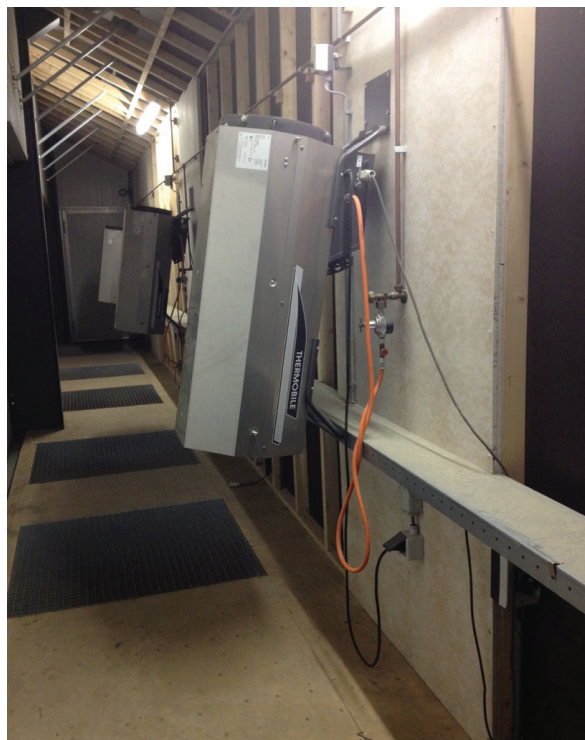
Centrale ventilatiegang met luchtverhitters
